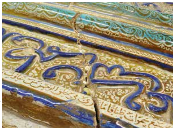
Трещина на плите
